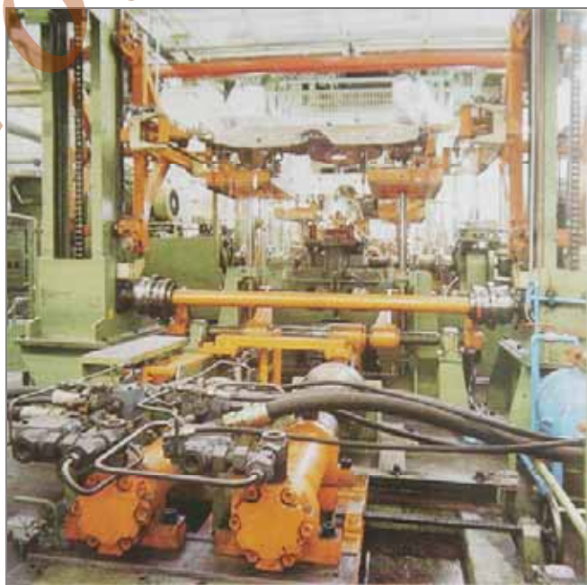
图 282. 图上方的一液压缸通过提升机构实现全部站台同步动作，另一液压缸备用。
